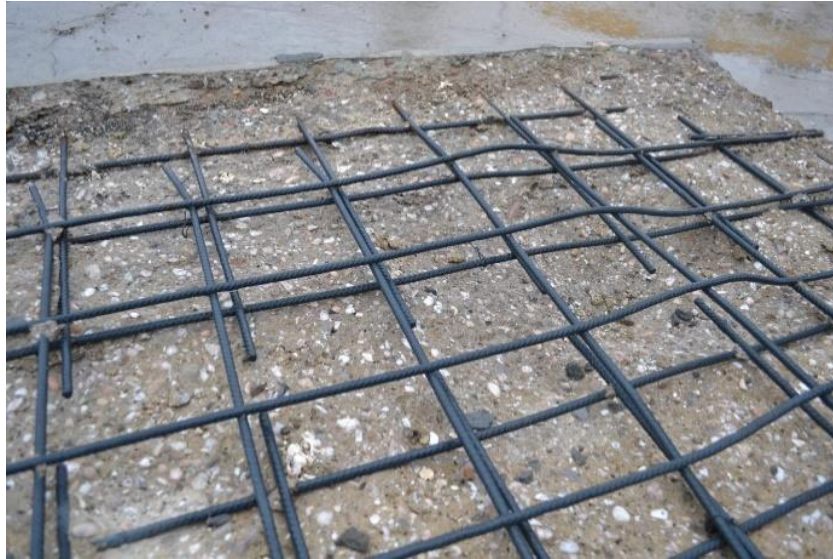
2.9. ábra: Az alsó panelem acélbetétéinek deformációja a tűzterhelés után (fotó Lublőy, 2018)
