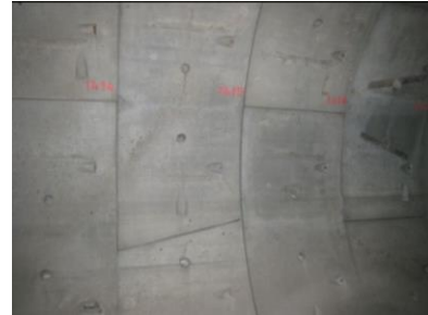
b) Beépített tübingelemek belső felülete
