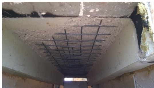
c) az etalon betonú TT panel a vizsgálat után
