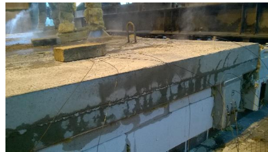
b) az etalon TT panel felbetonjának elválása
